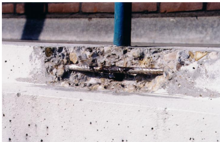
Constructieve schade in een betonnen ondergrond
